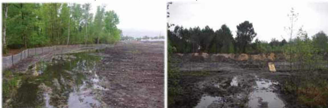
Ornières et flaques favorables aux amphibiens créés par des engins de chantier
